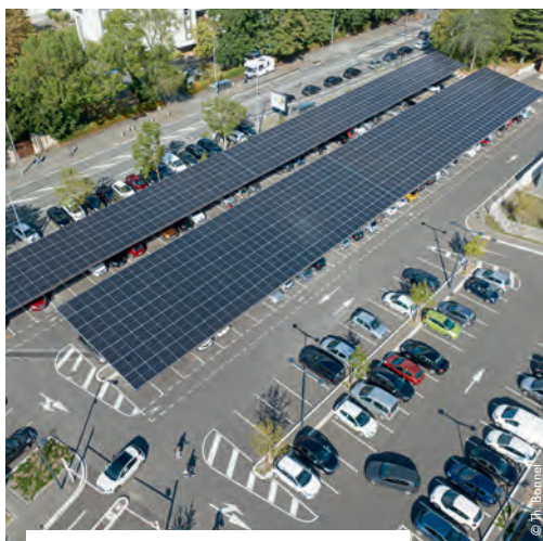
Ombrières du parking relais La Barre, à Belle-Beille, mis en service en 2025.
