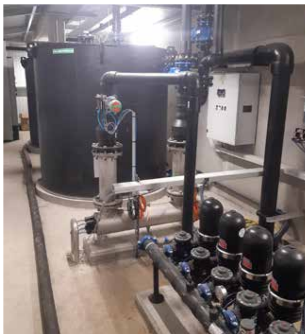
Figure 38. Installation de traitement des eaux usées traitées de la station d'épuration de la Baumette permettant d'arroser les espaces verts (Source : ALM)
