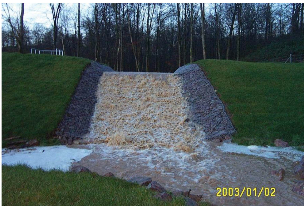
Déversoir d'orage rectangulaire en gabion
