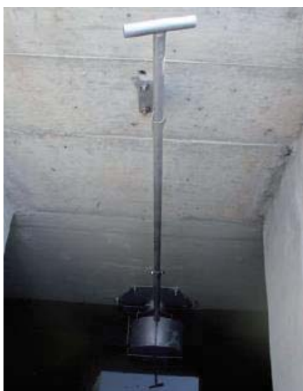
Ouvrage de fuite : Régulateur Vortex
