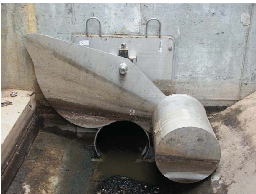
Ouvrage de fuite : Régulateur à flotteur
