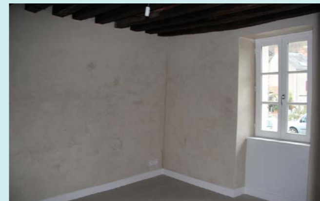
Finition par des enduits à la chaux naturelle posée sur l'enduit chaux-chanvre (Source : CREBA)
