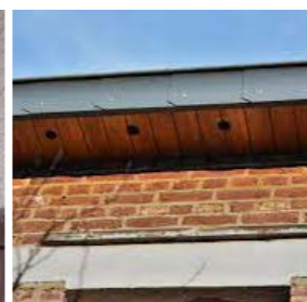
Corniche à martinets © Google
