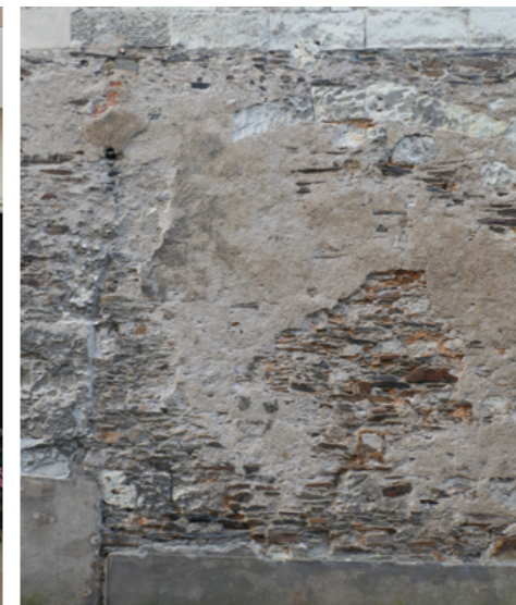
Enduit traditionnel à restaurer
