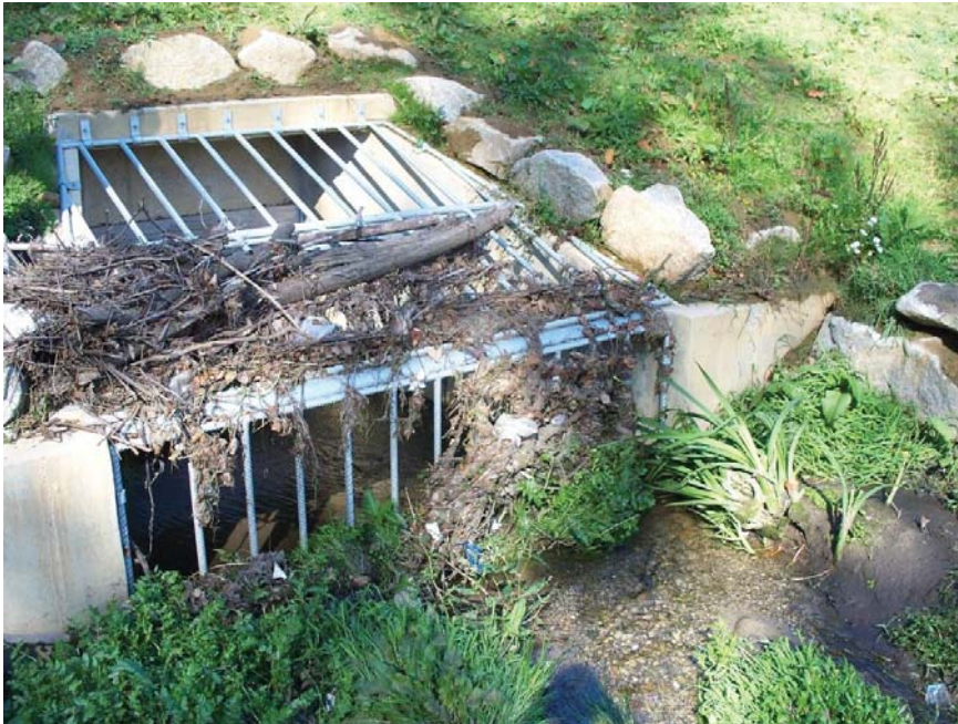
Ouvrage de fuite coté aval du bassin de rétention
