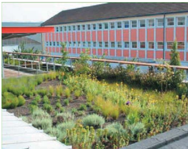
Toiture stockante végétalisée
