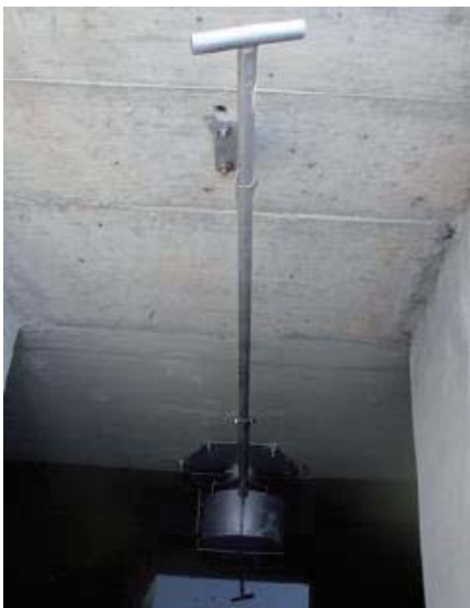
Ouvrage de fuite : Régulateur Vortex
