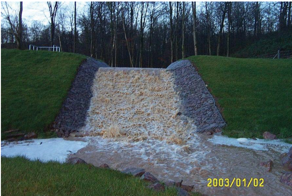
Déversoir d'orage rectangulaire en gabion
