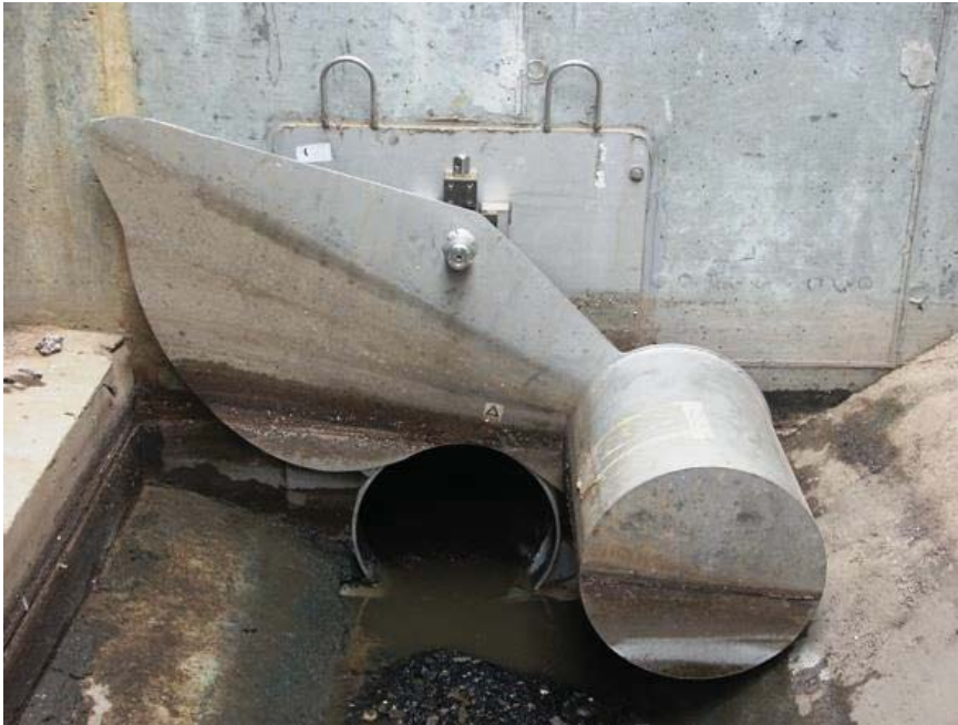
Ouvrage de fuite : Régulateur à flotteur
