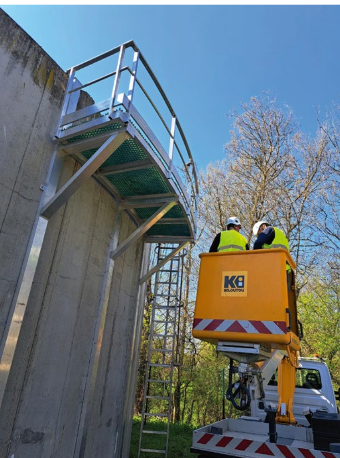
Passerelle et échelle à crinoline - STEP Mûrs-Erigné
