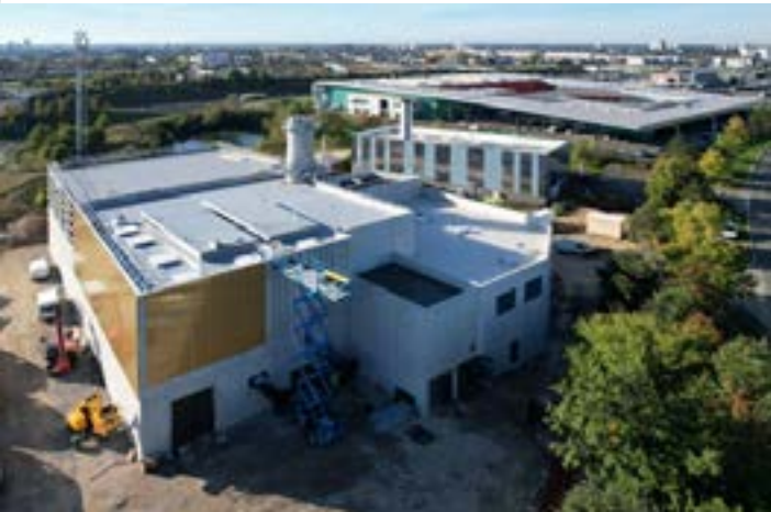
Chaufferie urbaine Mayenne 2 du réseau de chaleur « Angers Rive Droite » sur la ZAC du plateau de la Mayenne Mise en service en octobre 2025
