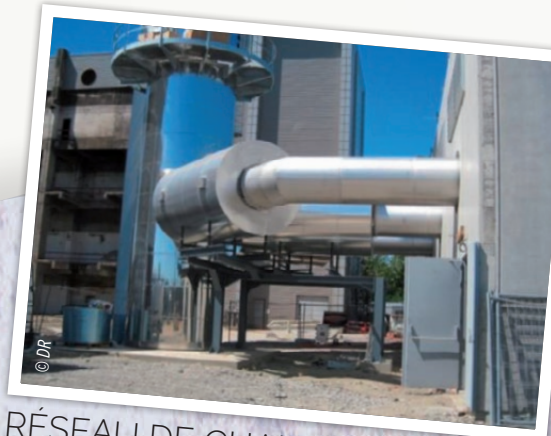
RÉSEAU DE CHALEUR
